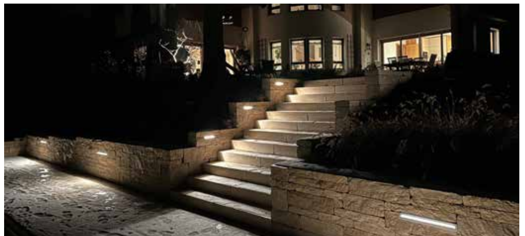
Down Light, Treppenbeleuchtung
